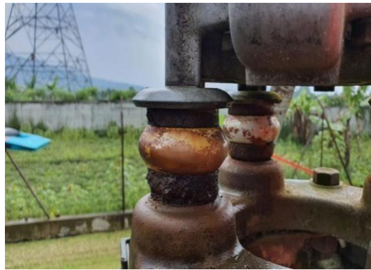
Gambar 3. Dudukan isolator tumpu Lightning Arrester (LA) korosif
